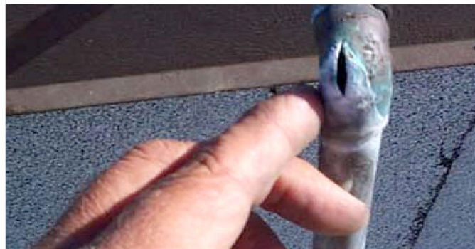
1 / Lorsqu'une conduite d'eau s'est rompue sur cette toiture ...
